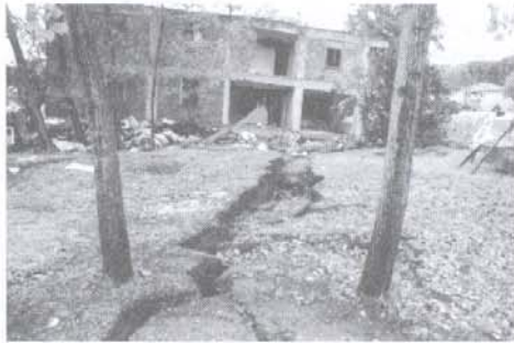
Geschädigtes dreigeschossiges Gebäude, welches sich auf der Oberflächenverwerfung in Yuvacik befand.
