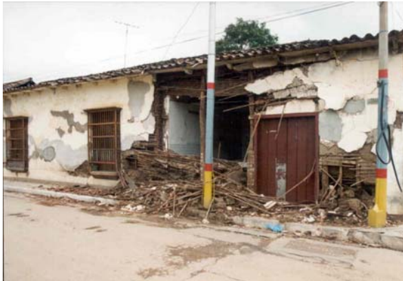
Abb. 7 „Bajareque“ - Bauweise mit typischen Schadensmustern
